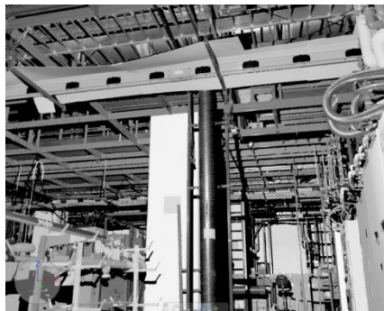
Scan of actual sub fab area
