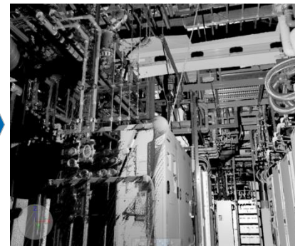
Scan of actual sub fab area
